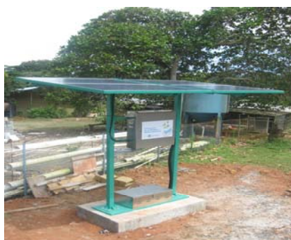
Panel solar instalado en la finca de La Ciudad del Niño, componente principal del proyecto.
