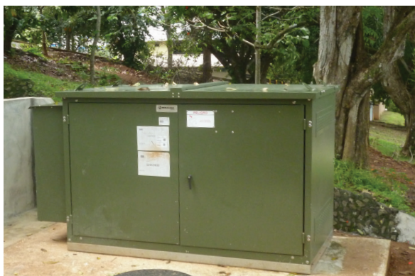
Transformador del área del Cine Universitario
