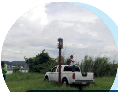
Instalación de uno de los monitores de calidad del aire por parte del personal de la Sección de Evaluaciones Ambientales del IEA en uno de los puntos de monitoreo en el Canal de Panamá
