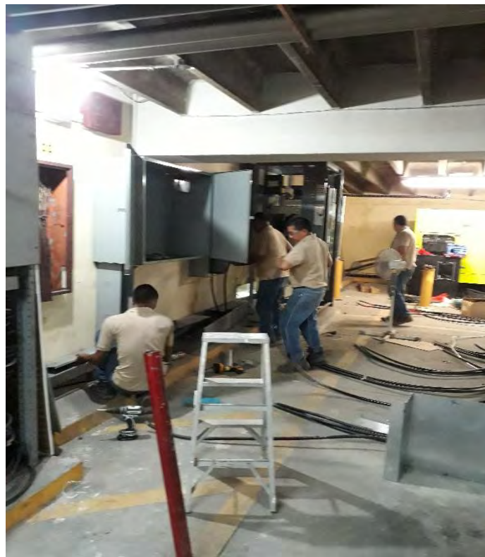
Trabajos de Cableado en Paneles Eléctricos Principales del Edificio Gusromares, Agosto de 2017.
