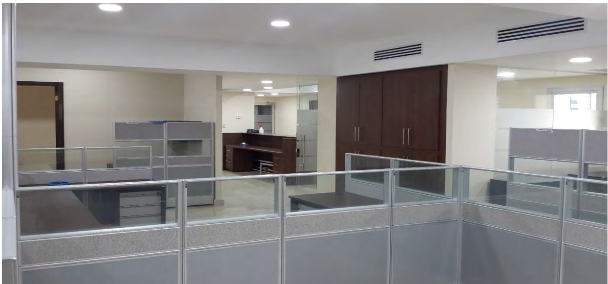
Trabajos de remodelación de Asesoría Económica y Financiera, piso 13, ambas alas. Abril de 2017.
