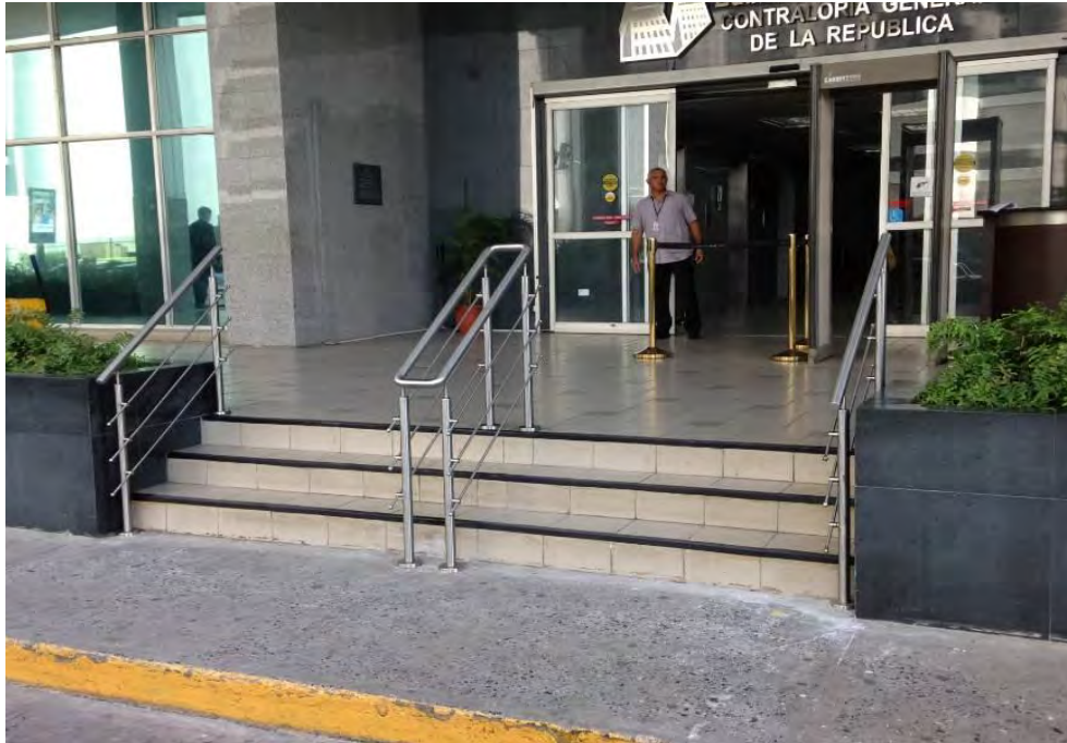
Suministro e instalación de pasamanos en la entrada principal del Edificio Sede. Mayo de 2017
