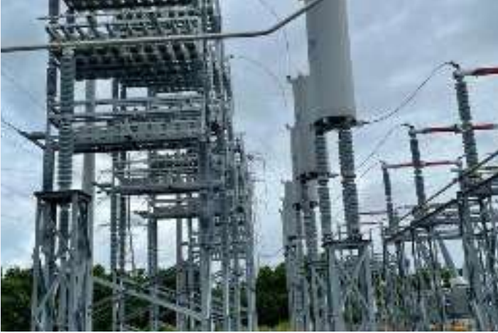
Banco de Capacitores en subestación San Bartolo.
