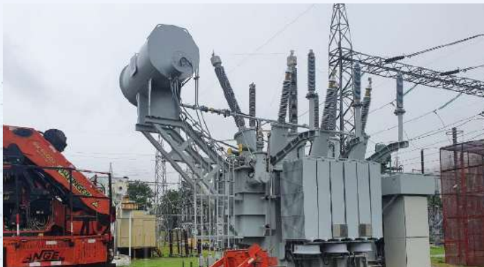
Nuevo transformador T2 en subestación Panamá.
