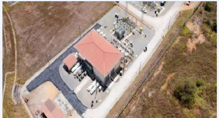
Vista aérea del STATCOM en subestación Llano Sánchez (Casa control de la esquina inferior derecha).
