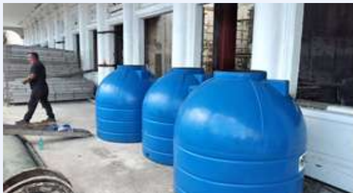
Sistema de bomba de agua de la Mansión Blanche.
