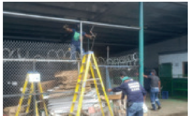
Reforzando la seguridad del depósito de almacén en Zona B – Carrasquilla
