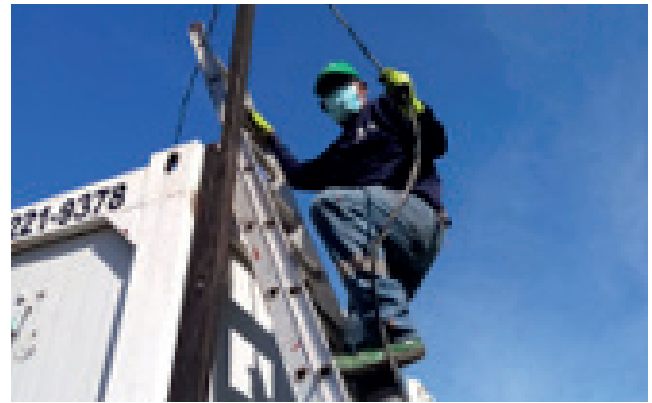
Suministro de energía eléctrica en contenedores que están ubicados en Zona D – Patacón para el personal de Servicios Técnicos.
