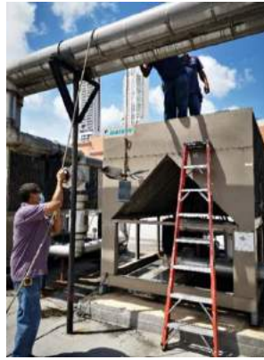
Mantenimiento preventivo de los dos Chiller ubicados en la azotea del Edificio Pedro Galindo.
