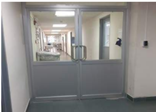
Se colocó puertas dobles en el 2do piso del LCRSP y en Alimentos y Aguas.
