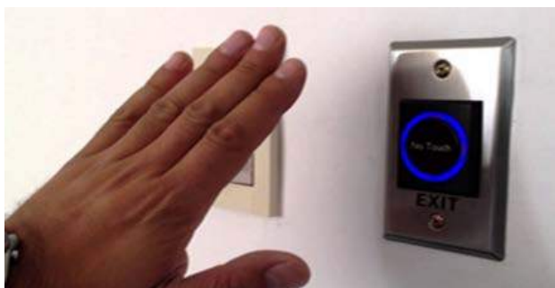
Botones de Apertura No Touch debido a la pandemia por COVID-19 para la apertura de las puertas con controles de acceso.
