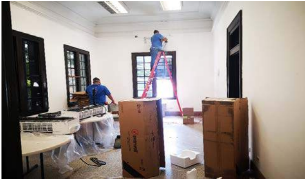
Instalación de dos unidades de aire acondicionado tipo SPLIT de 36,000 BTU, como habilitación del área de Enterprise.
