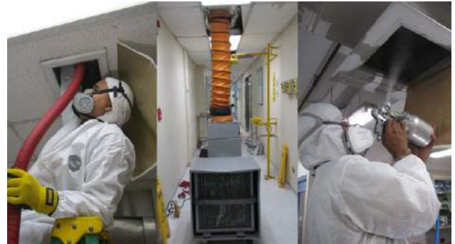
Servicio de mantenimiento de limpieza interna de ductos de aire acondicionado en el Edificio Pedro Galindo y el Edificio de Investigaciones.
