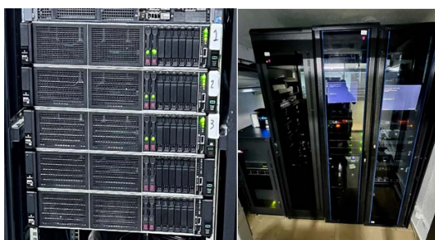
Servidores instalados en la Unidad de Informática del ICGES.
