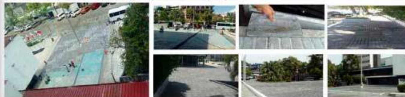
Instalación del revestimiento del piso (tocho) de la plaza de la entrada principal
