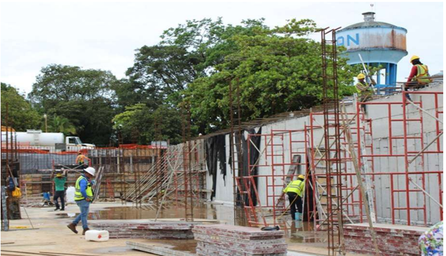
David Fase 1. Construcción del nuevo tanque de reserva de la PTAP de Los Algarrobos.
