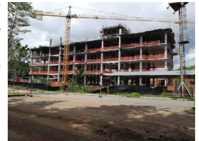
Avances en la Construcción del Edificio de Aulas de Clases, Campus Dr. Víctor Levi Sasso
