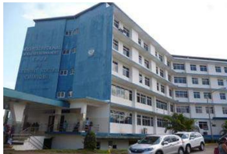
Estudio patológico y evaluación estructural del Hospital Regional Dr. Rafael Hernández de la Caja de Seguro Social, provincia de Chiriquí
