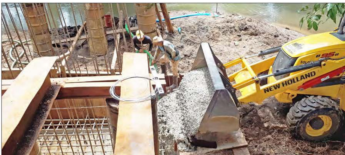
Construcción de puente vehicular en Cascajilloso, corregimiento de Arenas, distrito de Mariato, provincia de Veraguas.
