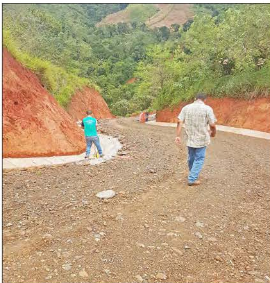
Proyecto de rehabilitación de carretera y construcción de drenaje en Las Huacas, distrito de Las Minas, provincia de Herrera.
