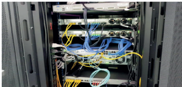
Proyecto SAN 1 Equipo Integrado Storage Area Network.
